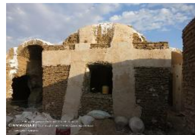
تصویر ۲۷: اجرای باریکه‌های تقویتی با اندود گچ در خانه روستایی اصفهک (مآخذ: پارسی و منصور، ۱۳۹۵).
